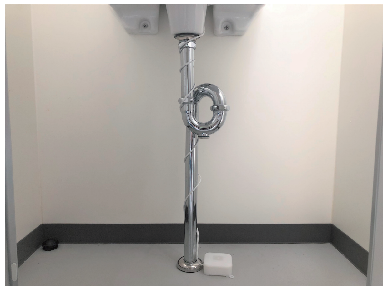
パイプの漏水
